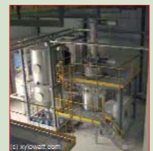
Gazogène Xylowatt pour Seco-bois
